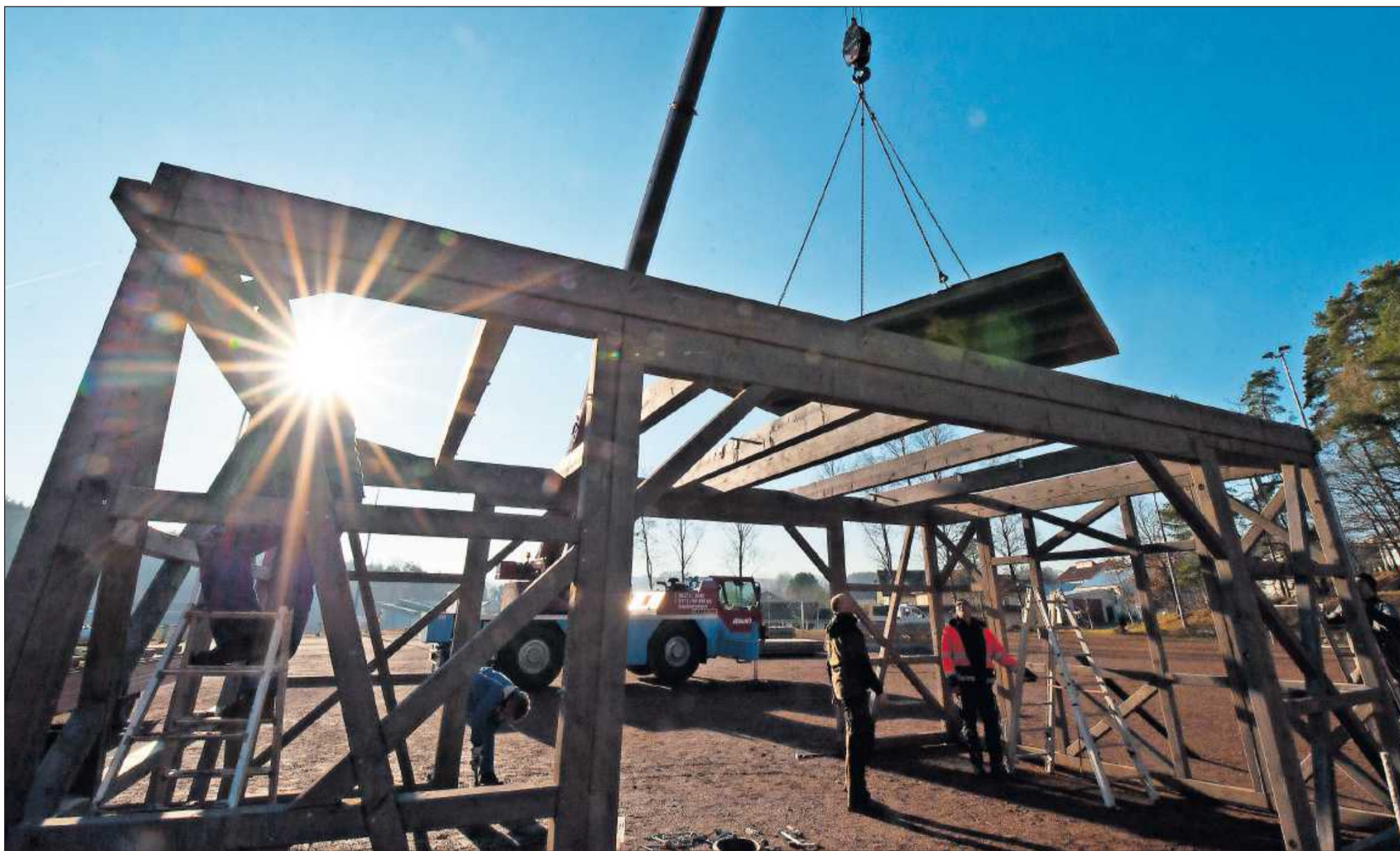
Viel Holz für den Cyclocross: Material im Wert von mehr als 14.000 Euro wurden für die Konstruktion der Brücke verbaut, über die später die Radfahrer brausen werden.
